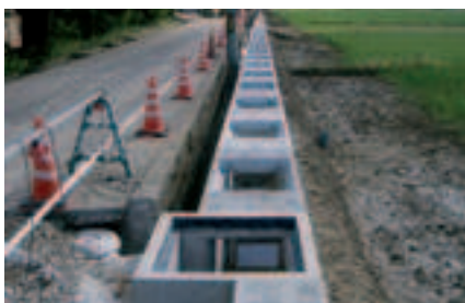
3a: Odwodnienie zabudowane na placu budowy.
